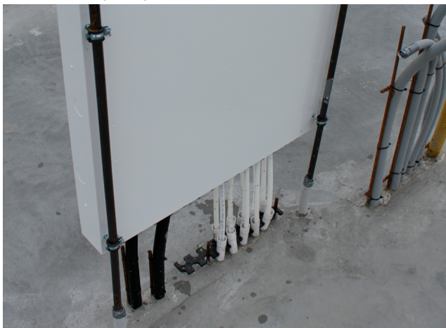
Asennettu LK Kaappiteline L2.
