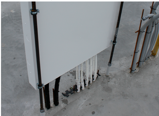
Asennettu LK Kaappiteline L2.
