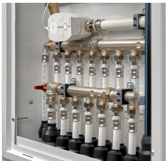
Vedenvalvontayksikkö asennettuna kaappiin.
