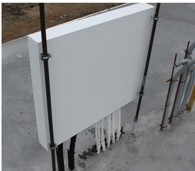
Asennettu kaappiteline L2
