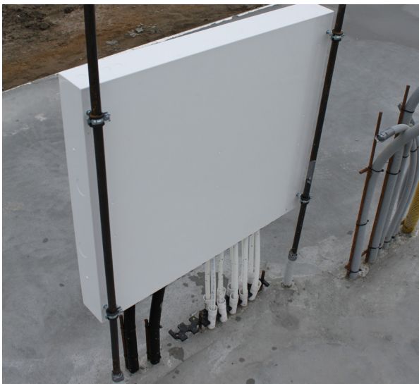
Asennettu kaappiteline L2.
