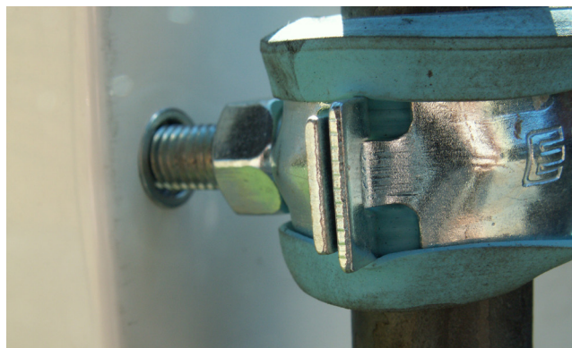
Lähikuva telineen kiinnityksestä kaappiin.
