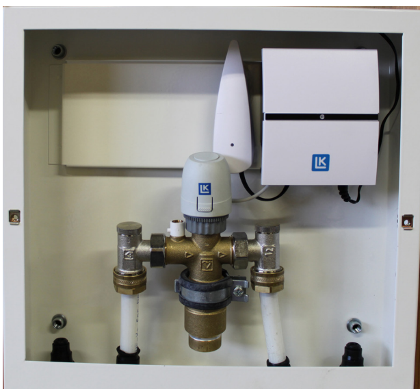
LK Minipiiriventtiili M5 varustettuna säätöjärjestelmällä LK ICS-RF1. Kokonaisuus on asennettu LK Seinään upotettavaan kaappiin M5 VT-XL.
