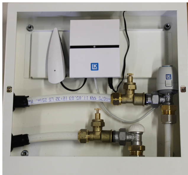
LK 1-piirisarja varustettuna sarjalla LK Liitinsarja RF/1-piirisarja sekä säätöjärjestelmällä LK ICS-RF1. Kokonaisuus on asennettu LK Seinään upotettavaan kaappiin M5 VT-XL.
