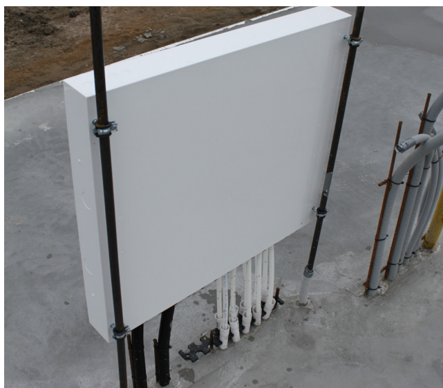
Asennettu kaappiteline L2
