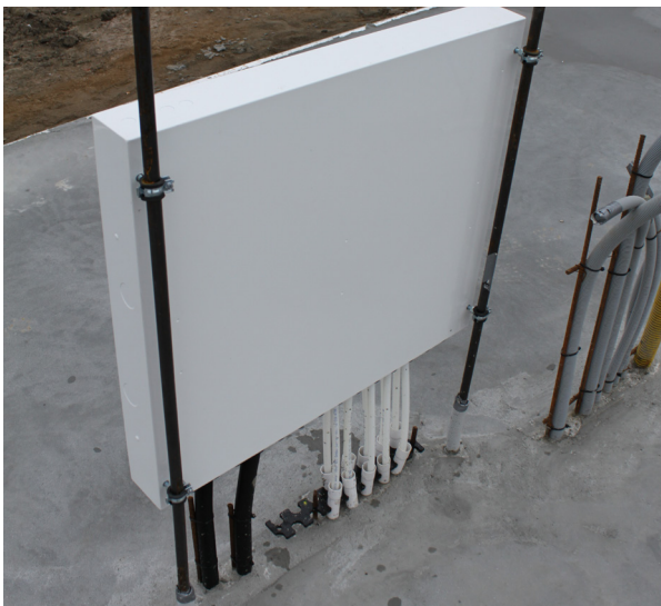
Asennettu kaappiteline L2.
