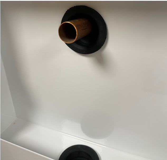
Kaapin sisältä kaappiläpivienti ja kupariputki.
